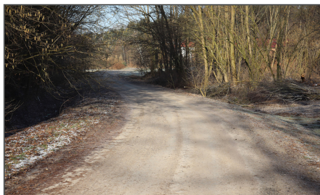
Droga w Węglunku wymagająca modernizacji
