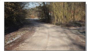
Droga w Węglinie wymagająca modernizacji
