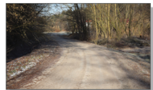
Droga w Węglinie wymagająca modernizacji
