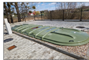
Oczyszczalnia ścieków w Krasnymstawie (identyczna technologicznie jak planowana oczyszczalnia w Batorzu)
